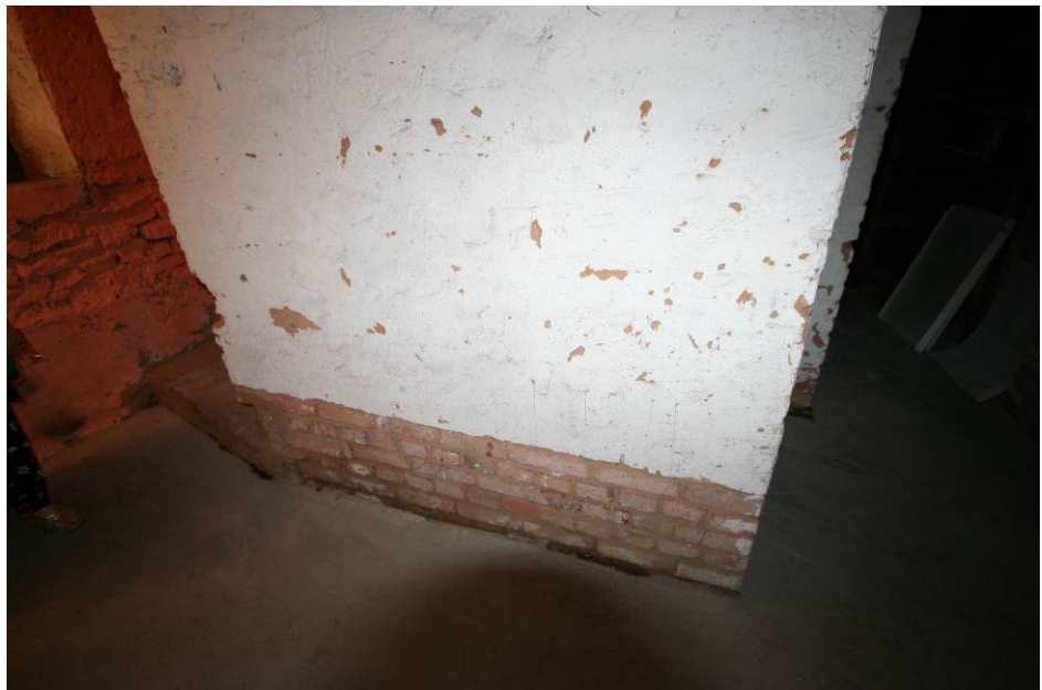
Keller mit Feuchtigkeitsschäden
