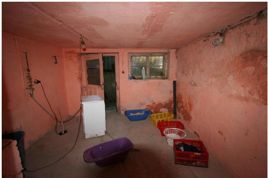
Keller mit Feuchtigkeitsschäden
