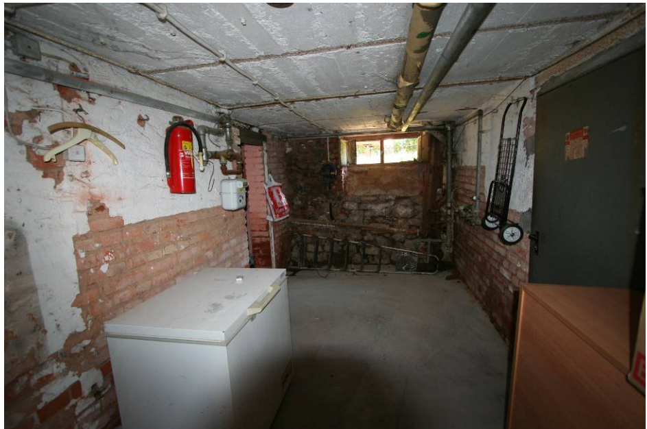
Keller mit Feuchtigkeitsschäden
