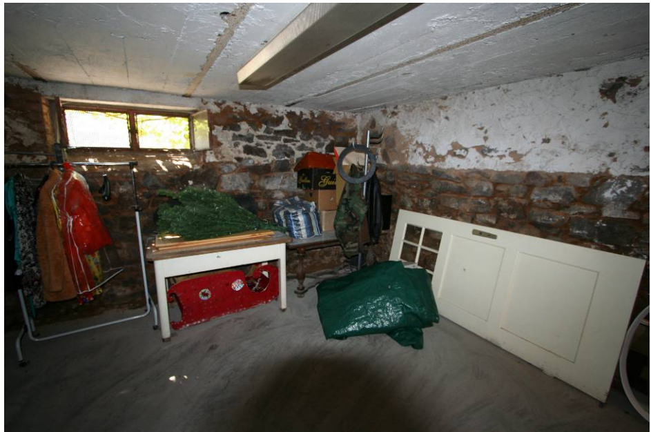
Keller mit Feuchtigkeitsschäden
