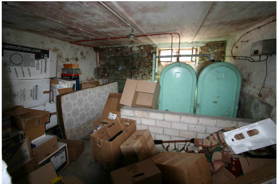
Keller mit Feuchtigkeitsschäden
