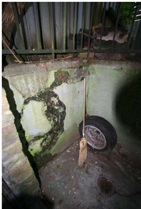
Kelleraußentreppe mit Feuchtigkeitsschäden
